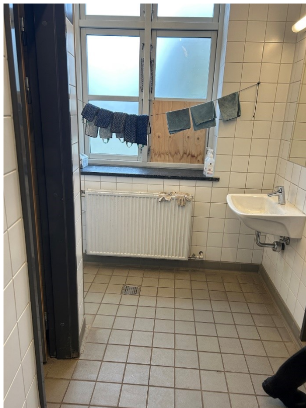
Toiletforhold på Garderkasernen i Høvelte.
