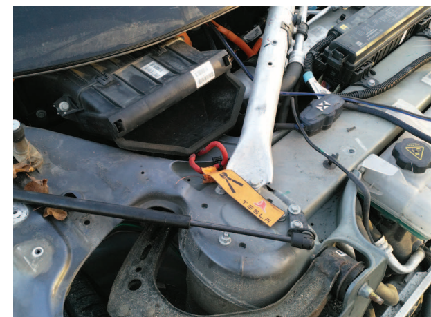
Ekstra mulighed for beredskabet til at sikre afbrydelse af spænding fra batteriet til motor i en ældre Tesla.
