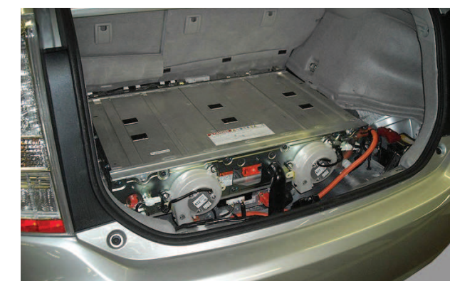
Batteri, placeret i bagagerummet. De to blæsere til køling af batteriet fremgår tydeligt
