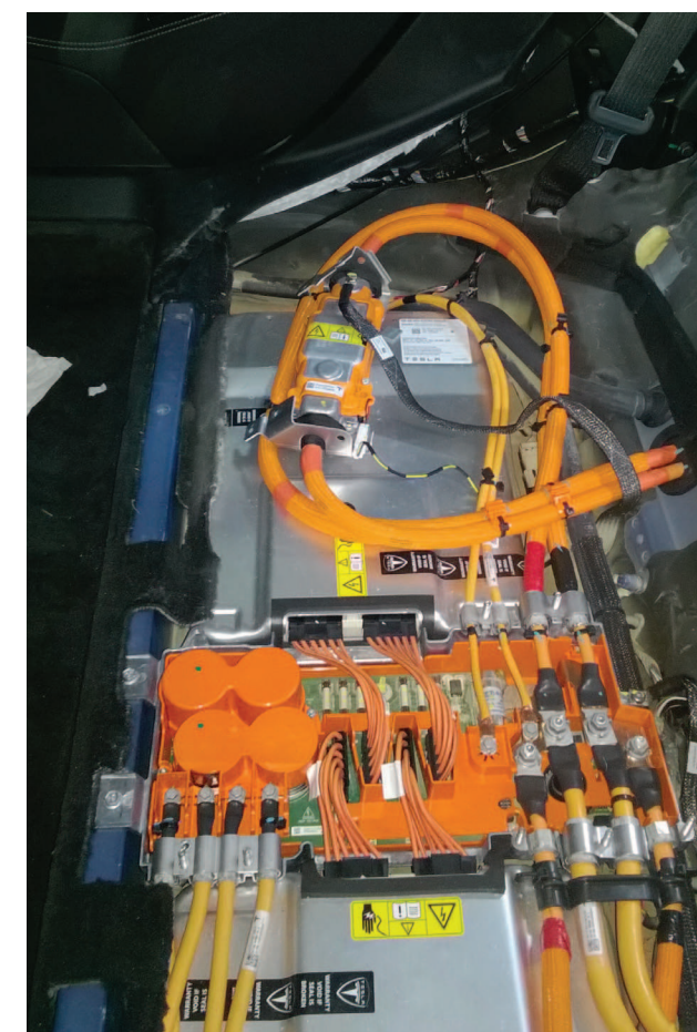
Advarselsskilte med høj spænding i motorrum.
