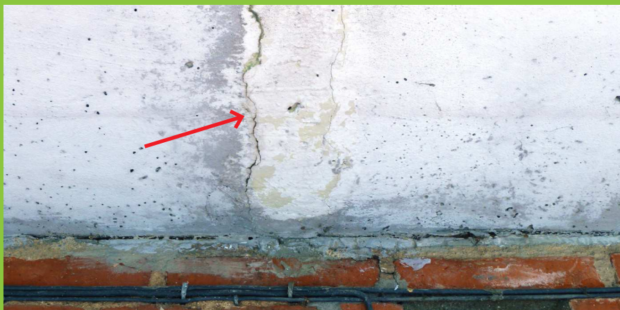
Figur 3: Altan med udliggerjern, hvor der ses revner og opbuling i undersiden, som er orienteret vinkelret på facaden. I dette tilfælde er revnen opstået som følge af korrosion på et overliggende udliggerjern. Denne type revner og udbulinger kan både optræde i altanens over- og underside afhængig af, hvor på udliggerjernet korrosionen foregår. Bemærk, at der ikke ses rødbrune udfældninger i forbindelse med revnen, selv om der foregår korrosion.
