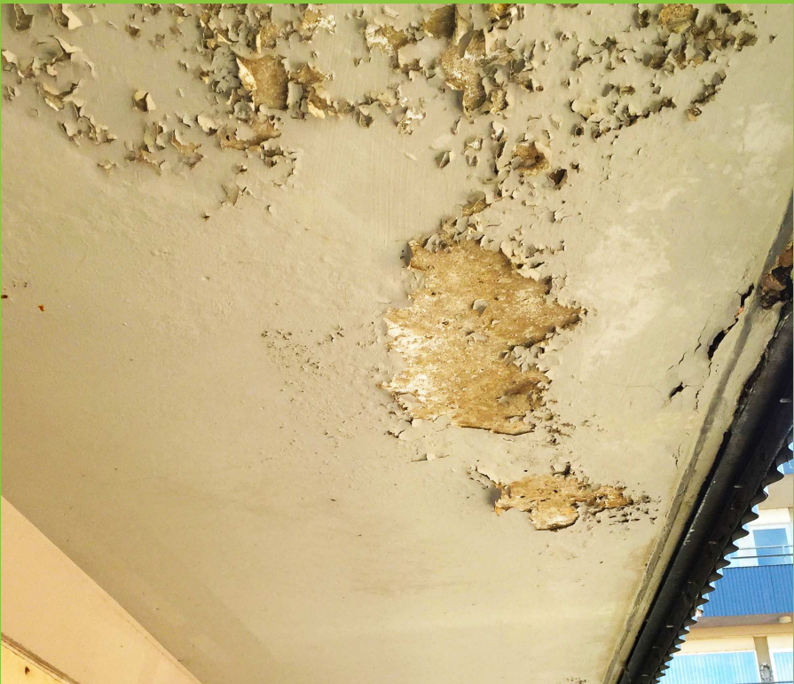
Figur 4: Afskalninger af maling og hvide udfældninger på underside af altan, hvilket indikerer, at der foregår en utilsigtet fugtpåvirkning af betonen.
