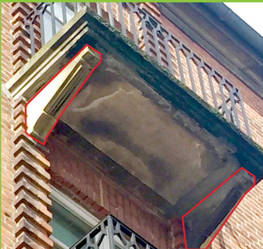
Figur 2: Altan med udliggerjern, som er udført med "pyntekonsoller" (markeret på foto), der kan give anledning til at tro, at det statiske system er anderledes end det i virkeligheden er.
