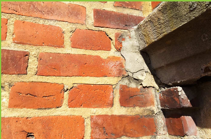
Figur 6: Revner i mørtelfuger omkring område med udliggerjern giver øget adgang for fugt til udliggerjern, hvilket kan være medvirkende til at initiere korrosion på stålprofilet.
