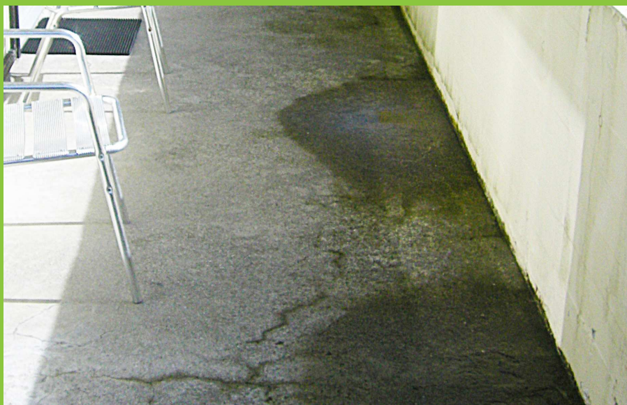
Figur 9: Altan hvor afvanding ikke foregår korrekt. I dette tilfælde opstår vandpytter mod brystning ved altanens forkant.
