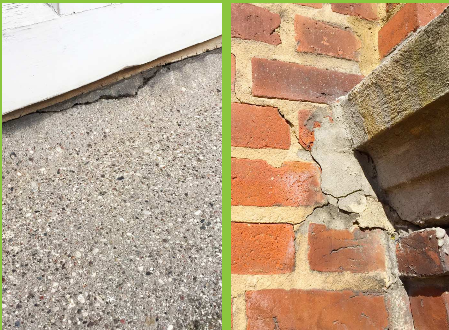
Figur 12: Venstre: Revne i hulkehl under terrassedør. Hulkehlen har normalt til formål at lede vand væk fra samlingen mod facaden, men hulkehlels funktion vil her lokalt være forringet. Højre: Revner i mørtelfuger i område, hvor altanplade møder facade, giver øget adgang for fugt til udliggerjern, hvilket kan være medvirkende til at initiere korrosion på jernene.
