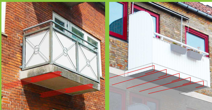
Figur 3: Venstre: Eksempel på udkraget altan med udliggerjern. Udliggerjernene er fastgjort til bjælkelaget inde i bygningen og er ført ud gennem facaden hvor de er omstøbt med beton. Der ses ofte fordelingsarmering i betonen mellem udliggerjernene, men den bærende funktion udgøres primært af udliggerjernene. Højre: Eksempel på udkraget altan med indstøbt armering. Etageadskillelsen er her udført i beton og er lokalt ført ud gennem facaden. Den bærende armering bør ligge i oversiden af altanpladen og er orienteret vinkelret på facaden.
