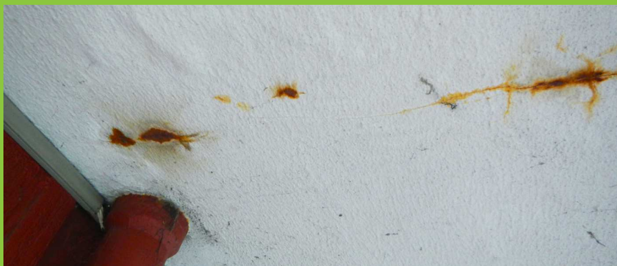
Figur 6: Revne i underside af altandæk med rødbrune udfældninger, hvilket giver en klar indikation på, at armeringskorrosion foregår.
