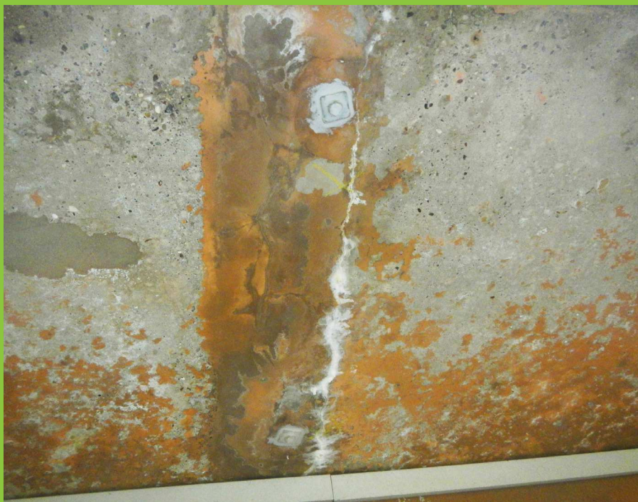
Figur 14: Altan med tværgående revne med hvide udfældninger. De hvide udfældninger i revnen indikerer, at der foregår en gennemsivning af vand, men det er uvist, hvorvidt korrosion af den indstøbte armering foregår. Revnen kan være særligt kritisk for simpelt understøttede altaner, fordi hovedparten af de bærende armeringsjern risikerer at stå i kontakt med revnen.
