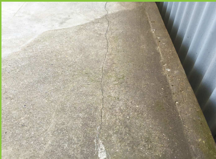
Figur 11: Revne i overside af altan orienteret parallelt med facade/forkant. Her er revnen orienteret nær forkanten, hvorfor revnens betydning er mindre kritisk for altanens bæreevne. Som tommelfingerregel kan anvendes, at jo tættere en sådan revne er på facaden, jo mere kritisk vil den potentielt være for altanens bæreevne.
