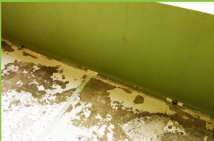
Figur 19: Øverst: Drypnæse (markeret på foto) ved forkant som i dette tilfælde er "indstøbt" i betonen. Drypnæsen sørger for at overfladevand drypper af ved altanens forkant og reducerer opfugtningen af altanens underside. Nederst: Udslidt/defekt belægning på overside af altan medfører øget opfugtning af betonen.
