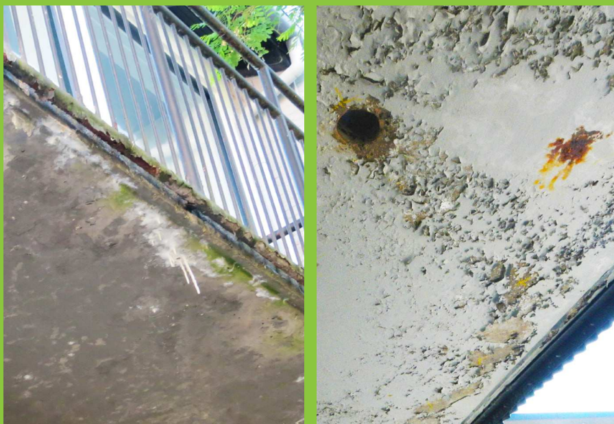
Figur 9: Venstre: Altan med kraftige hvide udfældninger på undersiden. Højre: Altan med kraftige malingsafskalninger på undersiden. Begge tilfælde giver en klar antydning om, at betonen er udsat for fugtpåvirkning og gennemsvivning af vand.
