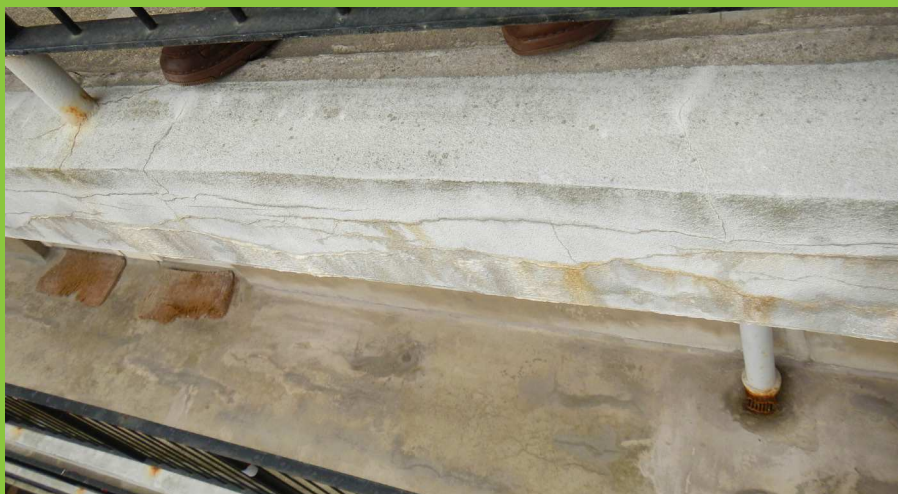
Figur 8: Vandrette revner i forkant, som indikerer, at betonen er delamineret. Der ses desuden hvide og brunlige udfældninger fra revnerne, som indikerer, at der foregår en fugttransport i revnerne. Delamineringer kan dog også optræde uden det giver sig udtryk i form af revner i forkanten. Derudover er mange altaner udført med rækværk eller brystninger, der skjuler altanernes forkanter, hvormed eventuel revnedannelse i forkanten vil være skjult.
