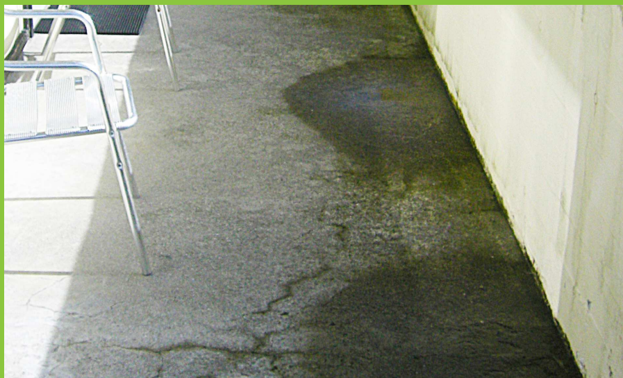
Figur 18: Altan hvor afvanding ikke foregår korrekt. I dette tilfælde opstår der vandpytter mod brystningen ved altanens forkant.
