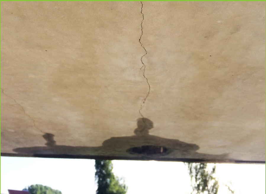
Figur 15: Altan med tværgående revner i undersiden. Hvis revnerne kun er synlige på undersiden og hvis revnevidden bliver mindre opefter (kan eventuelt ses på altanens forkant), kan det være en indikation på, at der er aktuelle problemer med altanens bæreevne.
