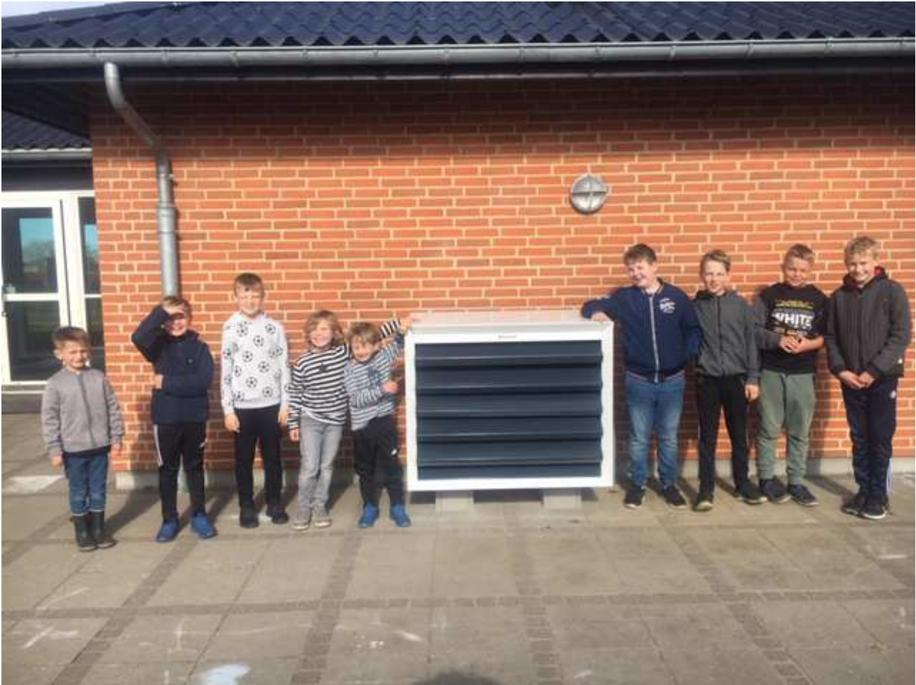
Figur 8 Udedel til Daikin gashybridvarmepumpen med beskyttende kabinet, placeret uden for pavillonen.
