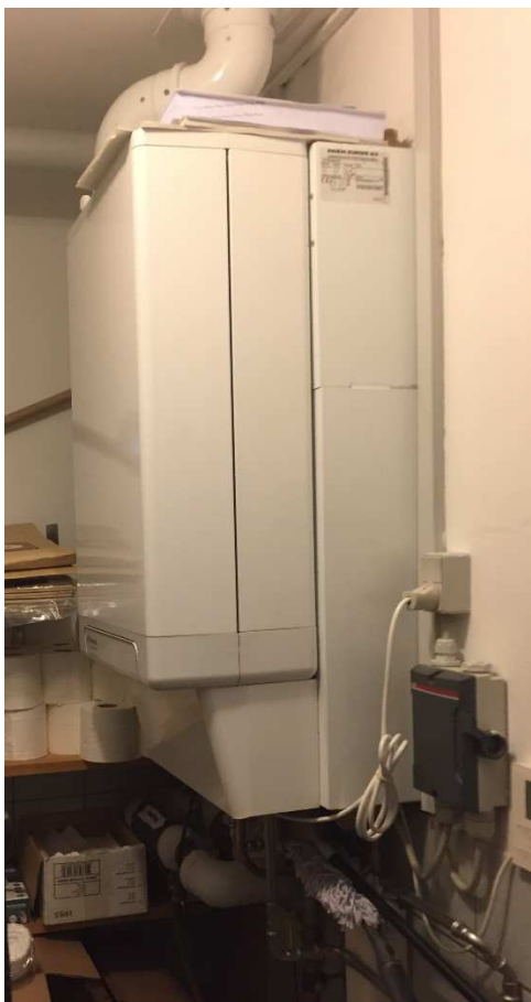
Figur 7 Daikin gashybridvarmepumpe placeret i en af skolens pavilloner med gasfyr og varmepumpens indedel bygget sammen i én unit.
