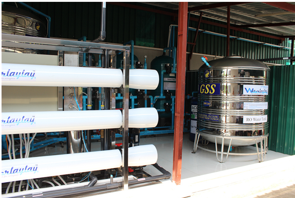
Et vandrensingsanlæg, som er medfinansieret af RBF, hos en mindre virksomhed, der producerer snacks. Billedet er fra Rigsrevisionens besøg.
