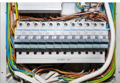
Elektrisk installation i huset 230-400 Volt AC
