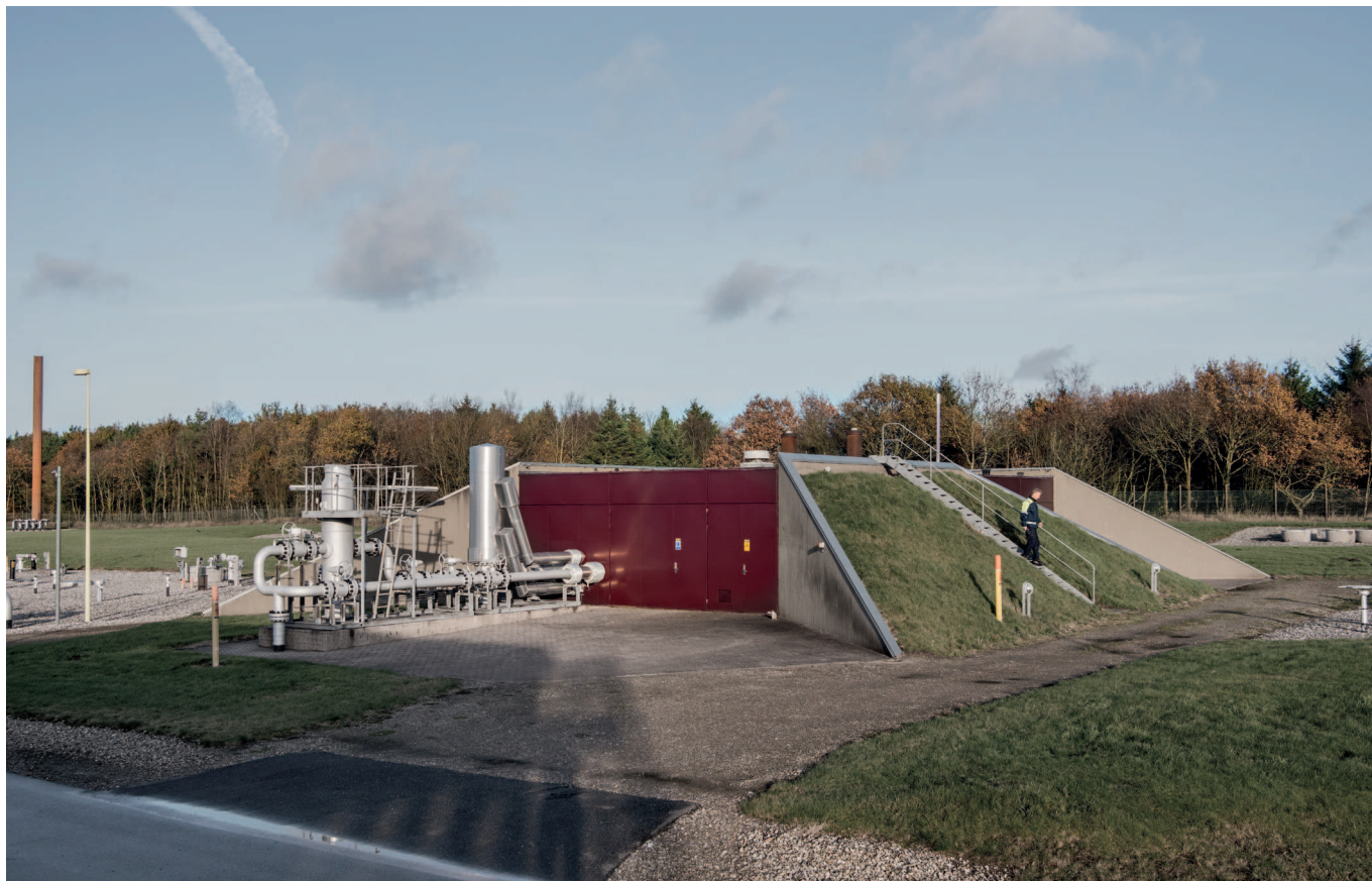
Måle og reguleringsstation i Egtved. Der findes 42 måle og reguleringsstationer tilknyttet det danske gastransmissionsnet. På stationerne nedreguleres tryk, gassen måles og odoriseres inden den sendes til distributionsnettet. Ved odorisering tilsættes sporstof, der sikrer at eventuelle utætheder kan lugtes.
