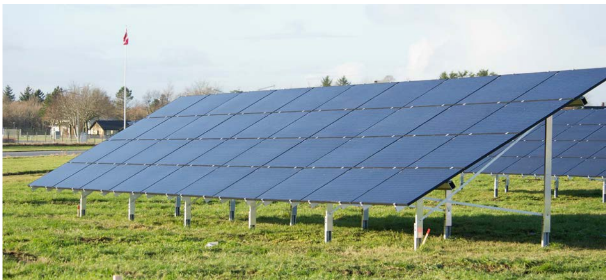
Solcelle anlæg på Flyvestation Skrydstrup.
