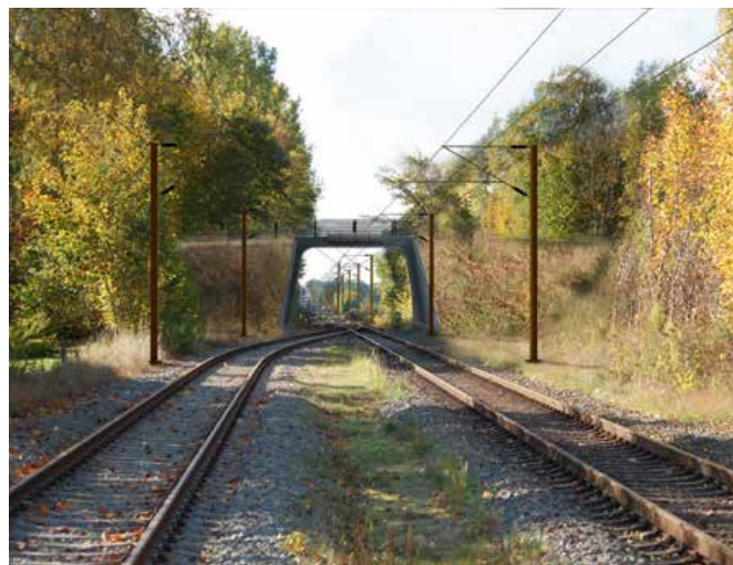
Vejbro ved Søllerupvej. Fremtidige forhold set mod syd.
