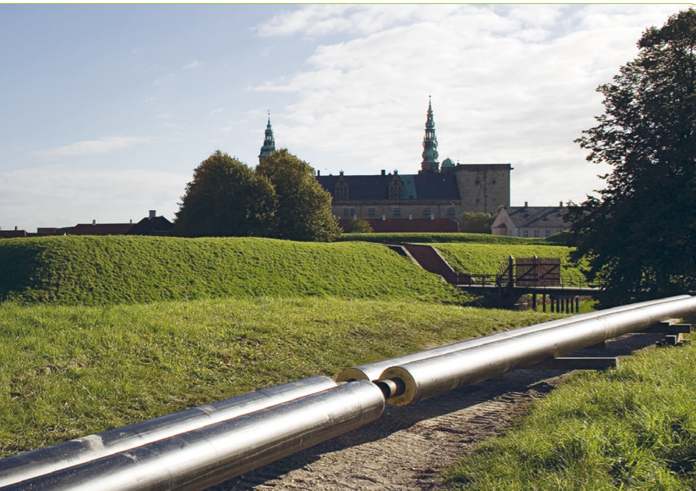
Kronborg, Helsingør får anlagt fjernvarme i 2008. Slottet har reduceret varmeforbruget med 25 %, og CO 2 -udledningen er mere end halveret siden installeringen af fjernvarme.
